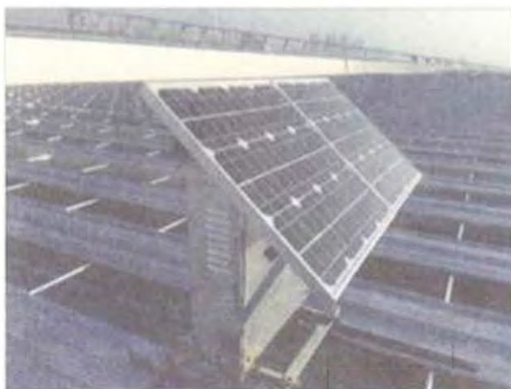
横向通风天窗上设光伏板
